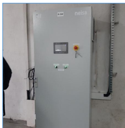
Nowa szafa sterownicza
